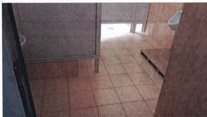
Фото №55 – Санитарно-гигиенические помещения (туалет)
